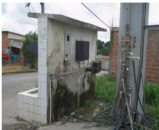
Imagem 25 – Ocupação Rio Piorini: estrutura destinada ao fornecimento de água dos moradores. Foto: Tatiana Barbosa, janeiro de 2009.
