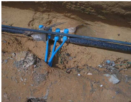
Imagem 28 – Ocupação Rio Piorini: fornecimento de água improvisado pelos donos dos lotes aos ocupantes.
