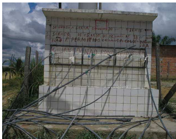
Imagem 26 – Ocupação Rio Piorini: estrutura destinada ao fornecimento de água dos moradores. Foto: Tatiana Barbosa, janeiro de 2009.
