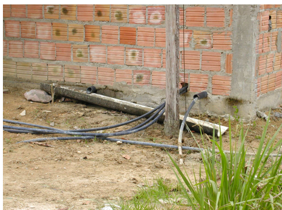
Imagem 27 – Ocupação Rio Piorini: fornecimento de água improvisado pelos donos dos lotes aos ocupantes.
