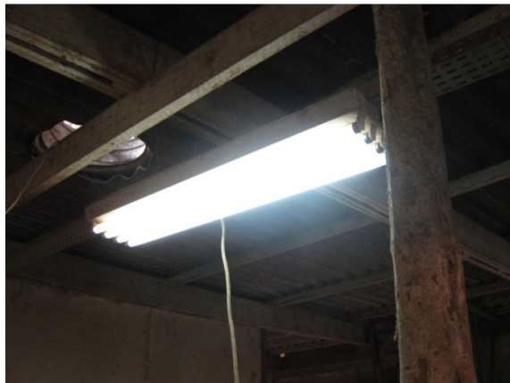
Figura 21- Foto do Sistema de Iluminação de uma das Empresas da Pesquisa.
