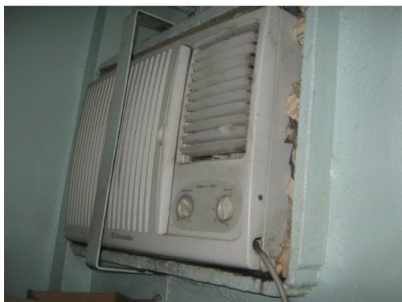
Figura 23- Foto do Ar condicionado de uma das Empresas da Pesquisa.
