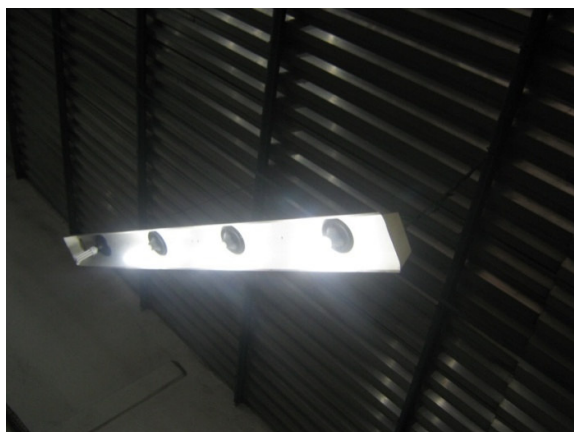
Figura 22 - Foto do Sistema de Iluminação de uma das Empresas da Pesquisa.
