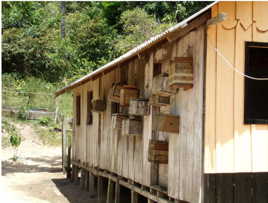
Fotografia 10 - Criação de abelha em local impróprio
