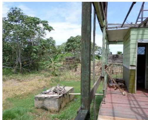
Figura 9. Fossa séptica da escola sujeita a inundações em Iranduba/AM
