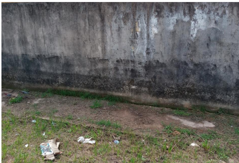
Figura 63: Marcas da cheia de 2012 – muro da Escola Senador João Bosco
