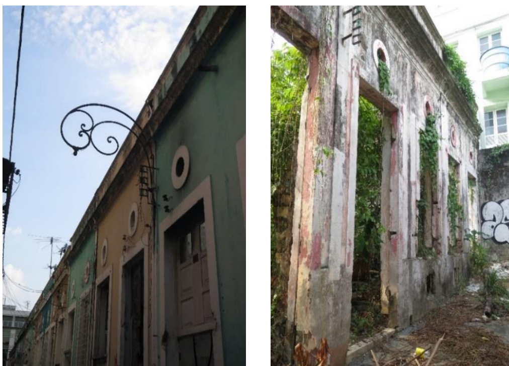
Figura 20 e Figura 21: Aspecto atual da via privada da vila.. À esquerda, casas que resistiram ao incêndio e à direita, as últimas ao fundo do lote, em ruínas e tomadas por vegetação além de servirem de lixeira.
