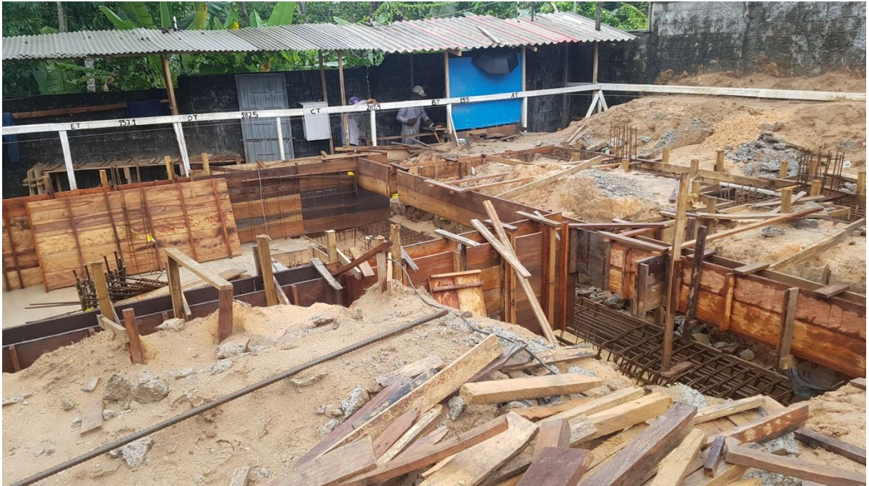
Figura 30: Local onde houve o erro de locação na obra (Próprio autor)
