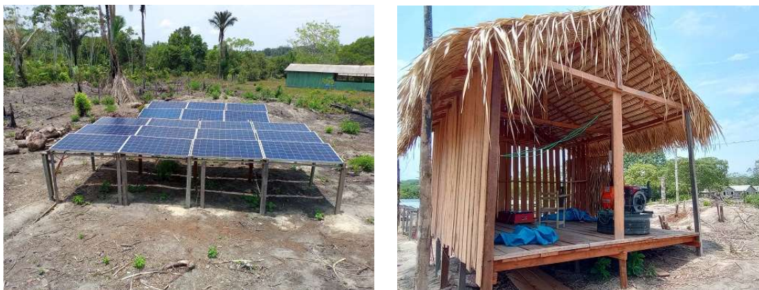
Figuras 6 e 7 – Estação de energia solar e gerador de energia
