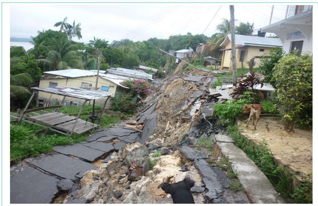
Figura 49: Ação danosa das terras caídas em São Paulo de Olivença-AM.
