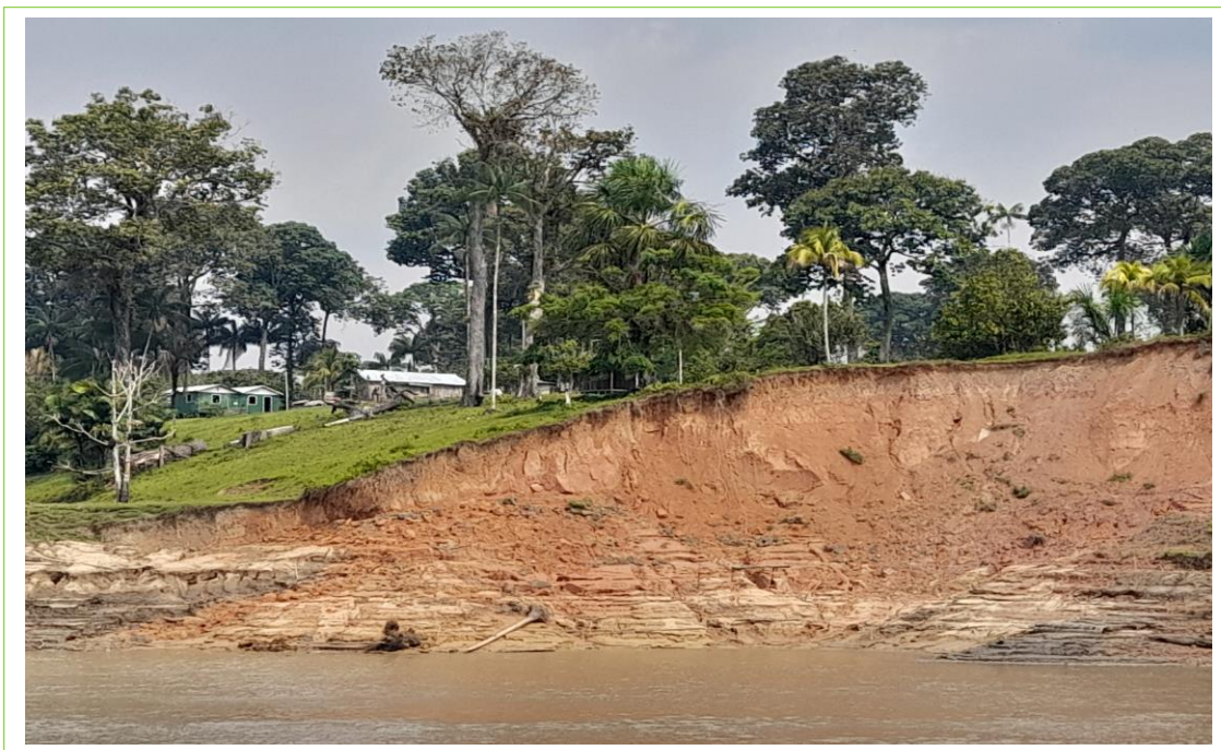
Figura 13: Terras caídas, denotação de seu poder erosivo.
