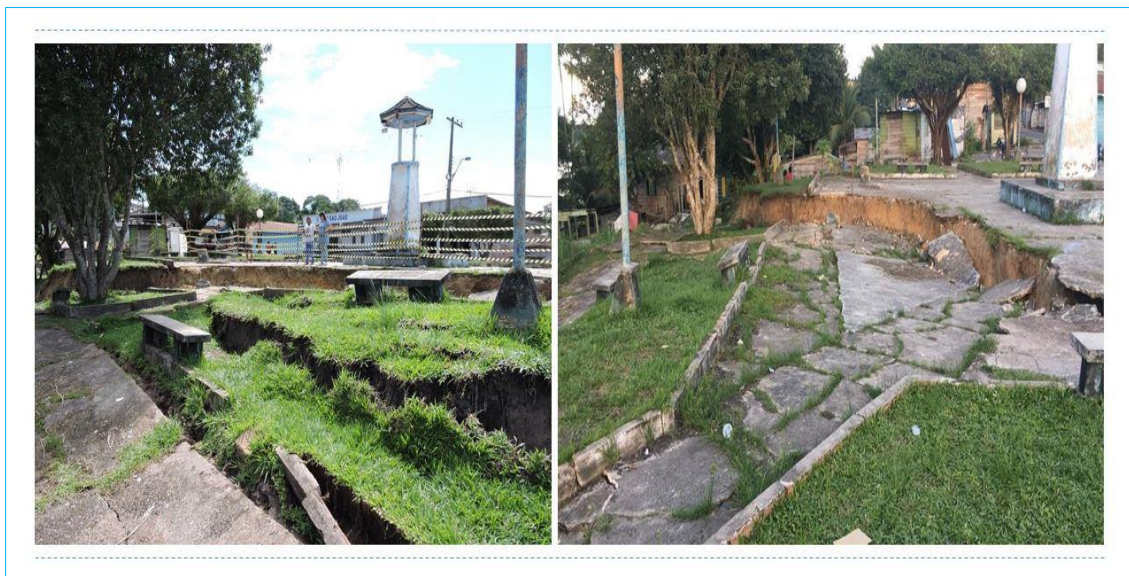
Figura 57: Ação erosiva na praça São João, cidade de São Paulo de Olivença-AM.
