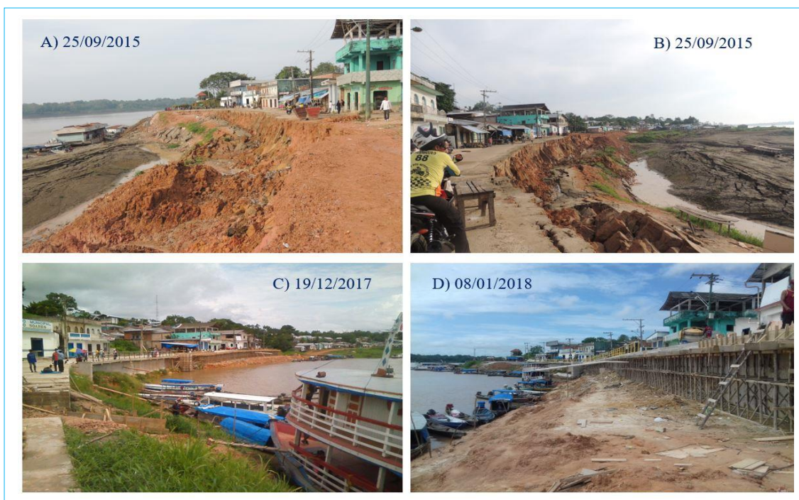
Figura 69: Episódio erosivo de 2015, e revitalização a partir de 2017.
