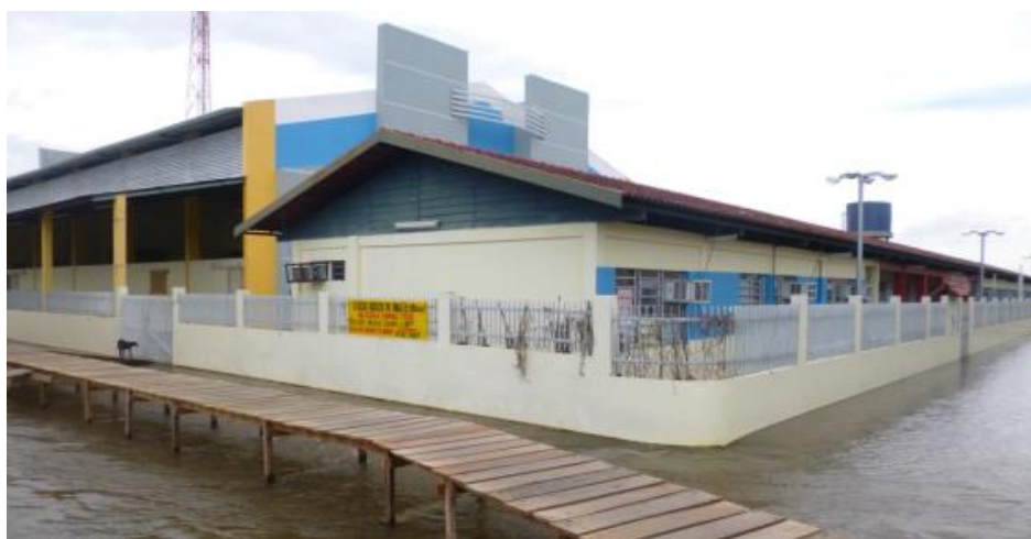
Figura 3 – Escola Estadual Coronel Fiúza em meio à inundação no Careiro da Várzea
