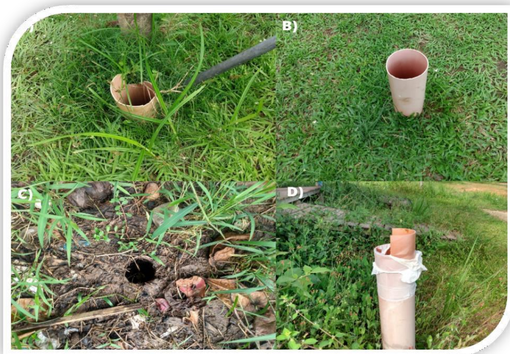
Figura 28: Poços Abandonados em estado ambiental de risco
