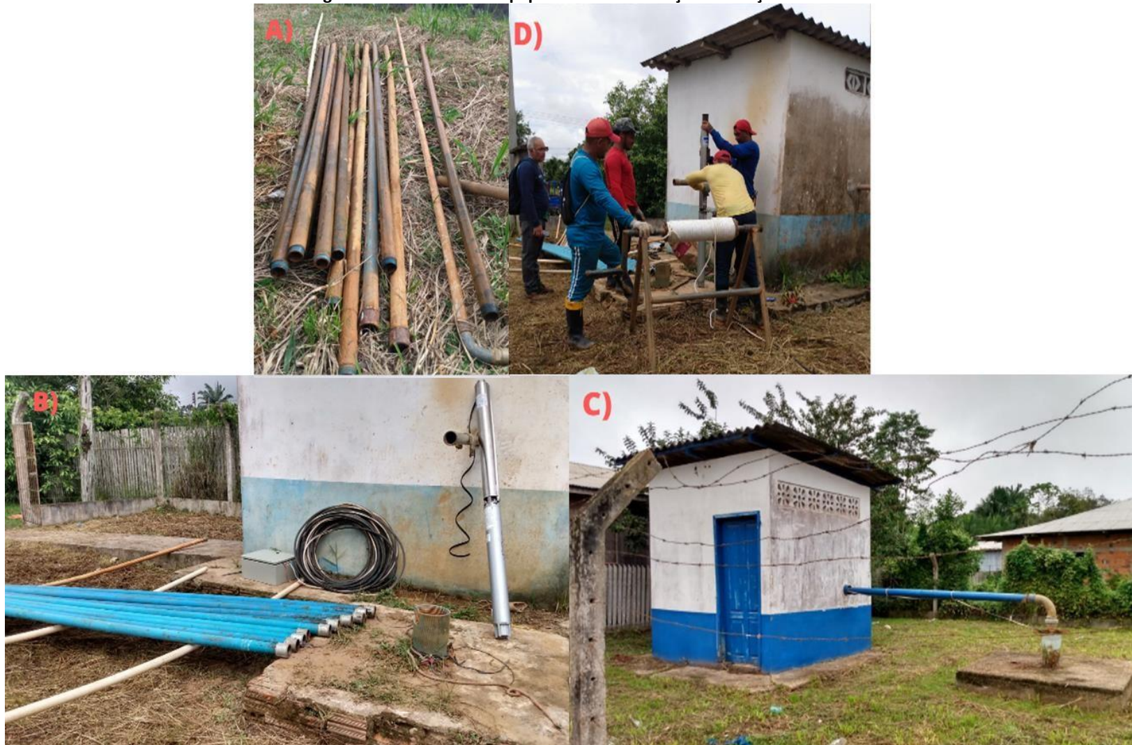
Figura 21: Mosaico com Equipamentos e Instalações de Poços Públicos
