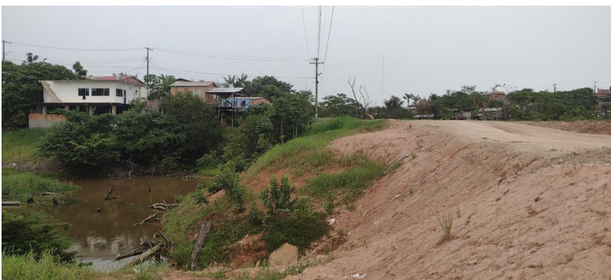
Figura 74: Processo erosivo no ponto P2 no igarapé Pêra.
