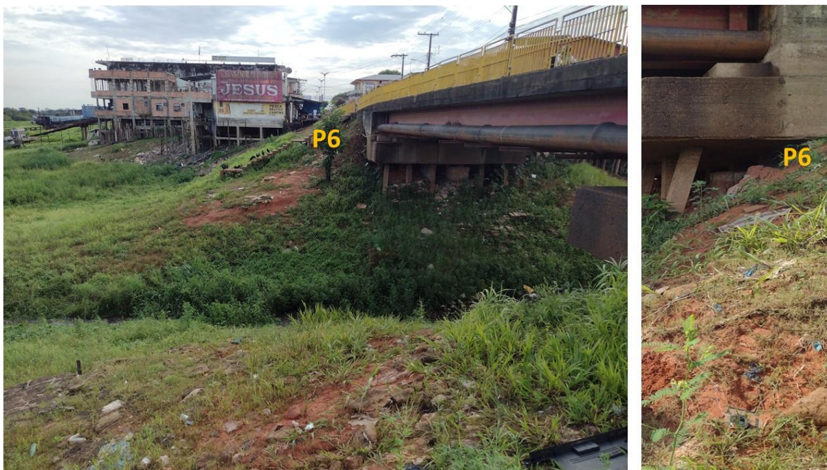
Figura 73: Processo erosivo no ponto P6 no Igarapé Espírito Santo.
