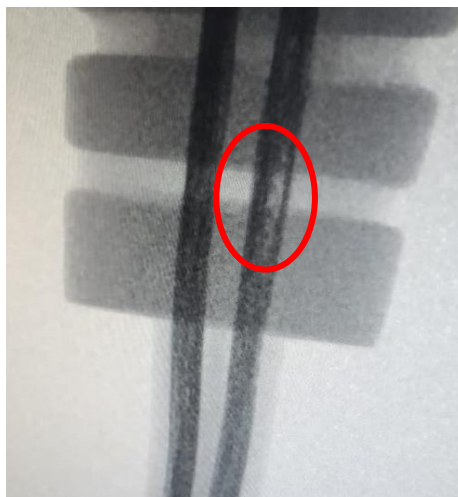
Figura 64 – Defeito interno de cabo quebrado
