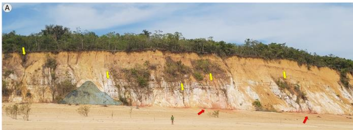
Figura 52 — Feições resultantes dos processos erosivos da falésia 5. Setas vermelhas. Erosão por solapamento; Setas amarelas. Sulcos.
