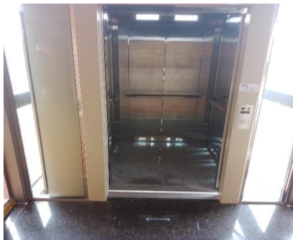
Figura 68: Elevador visto por dentro
