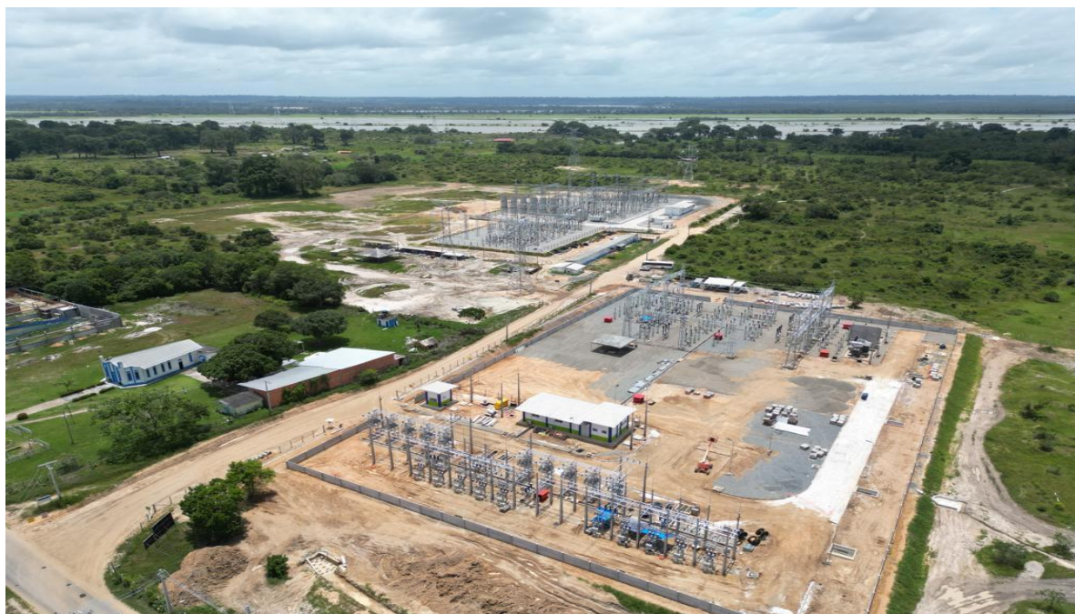
Figura 50 - Subestação Parintins 2 na cidade de Parintins-AM
