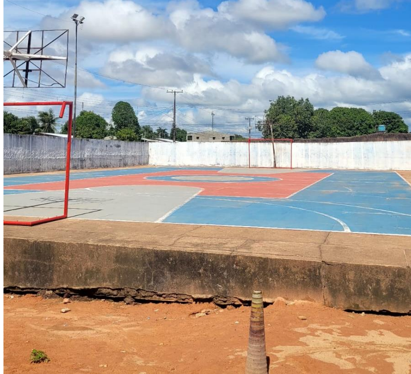
Figura 3. Estado atual da quadra desportiva da Escola Municipal Raymundo Chaves, Óbidos (PA)
