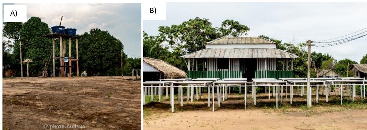
Figura 32. (A) Rede de captação e distribuição de água; (B) Sistema fotovoltaico off-grid instalado na comunidade
