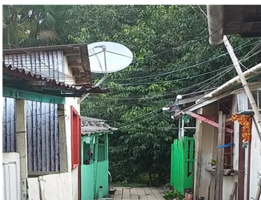
Figura 18 – Sistema de iluminação precário
