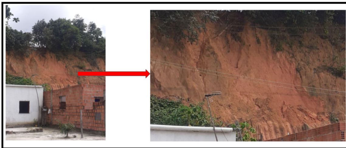
Figura 09: Talude na área central da Comunidade Buriti.
