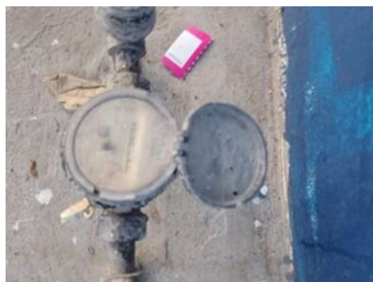
(B) Hidrômetro próximo à residência onde ocorre o vazamento.
