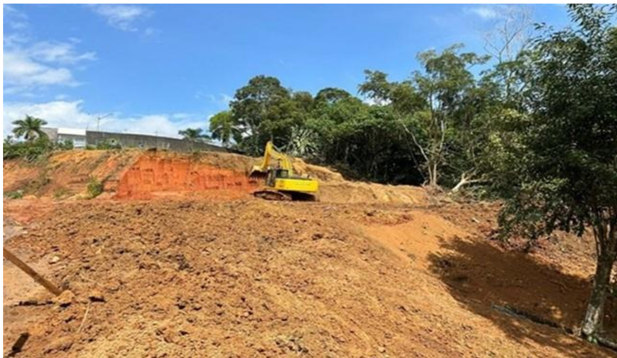
Figura 21 – Impacto em área de nascente do igarapé Água Branca.
