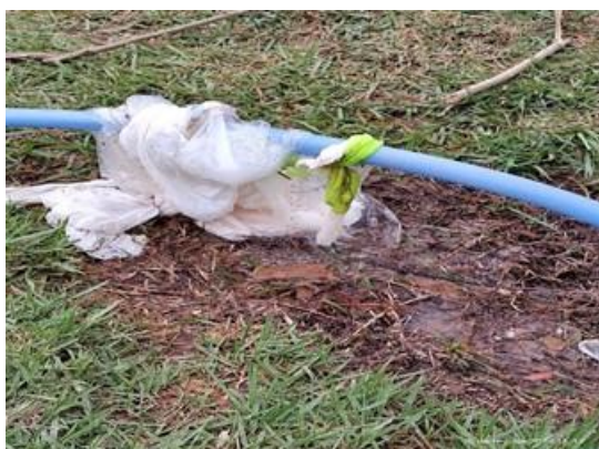
(A) Vazamento de água em rede de abastecimento.
