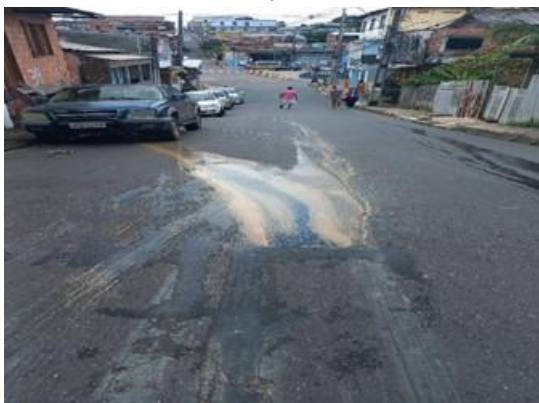
(C) Tubulação com vazamento em rede de abastecimento.
