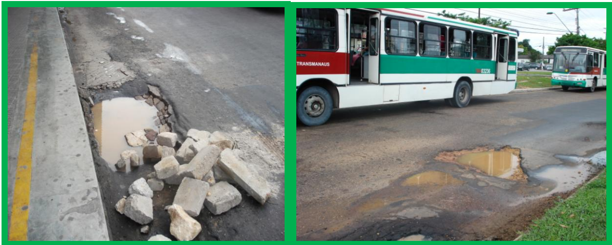
Figura 18- Condições precárias das vias.
