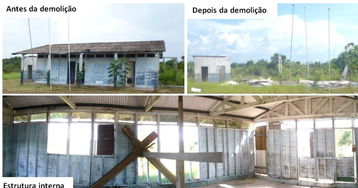
Figura 64 – Estrutura da antiga Escola Municipal Flor do Amazonas, demolida em 2012, comunidade Fé em Deus
