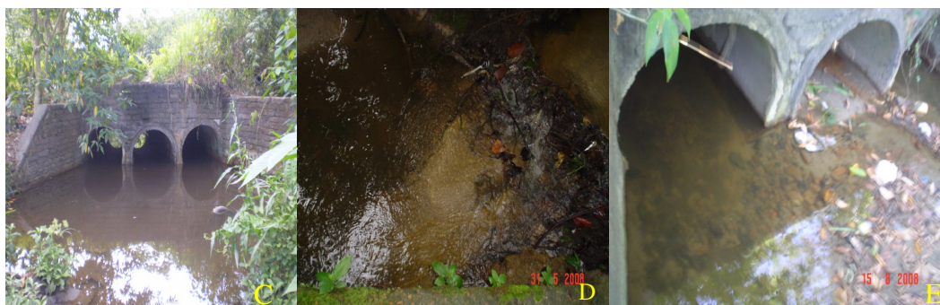
Figura 31: C – visão parcial do encontro das duas nascentes do parque Sumaúma (jul/2007). D – (mai/2008) e E (15 de ago/2008).
