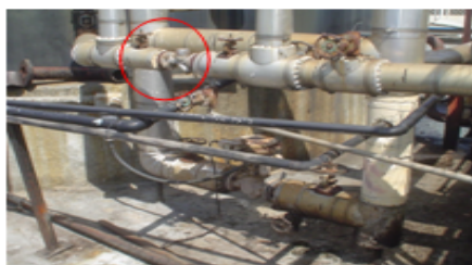
Drenagem do tanque principal de óleo BPF reciclado
