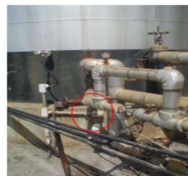
Drenagem do tanque principal de óleo BPF
