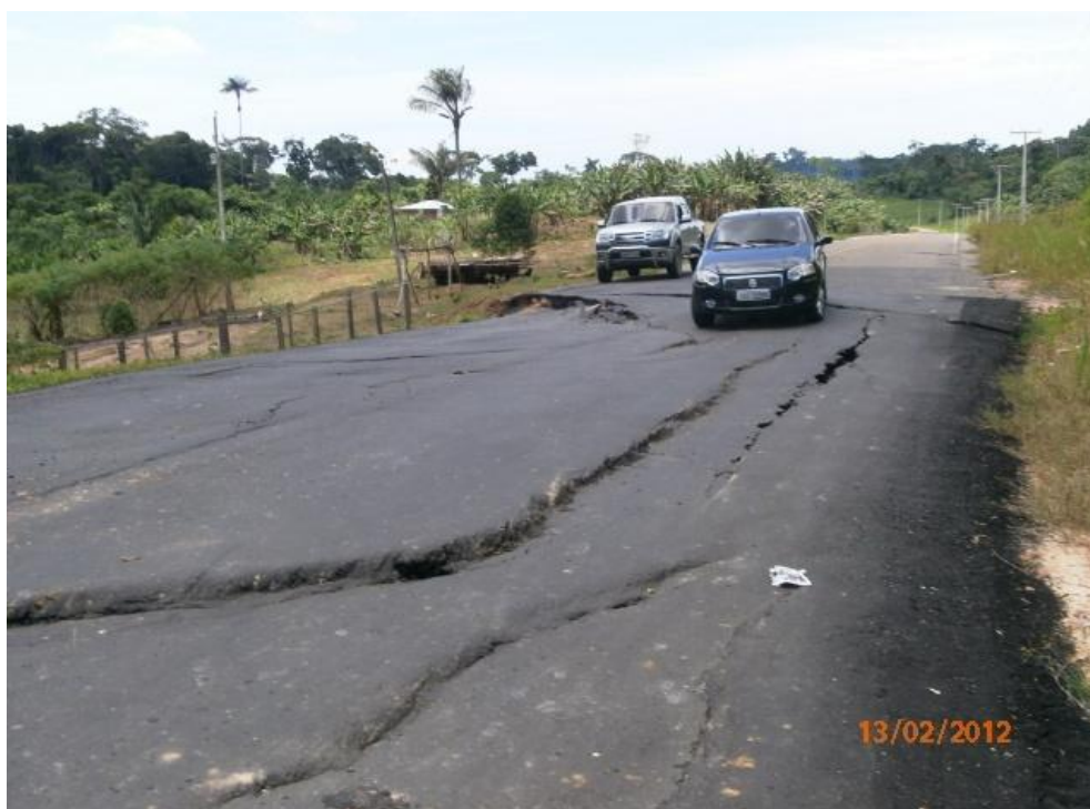
Figura 54: BR-307- Asfalto cedendo no 22 km Fonte: SECON (2012)
