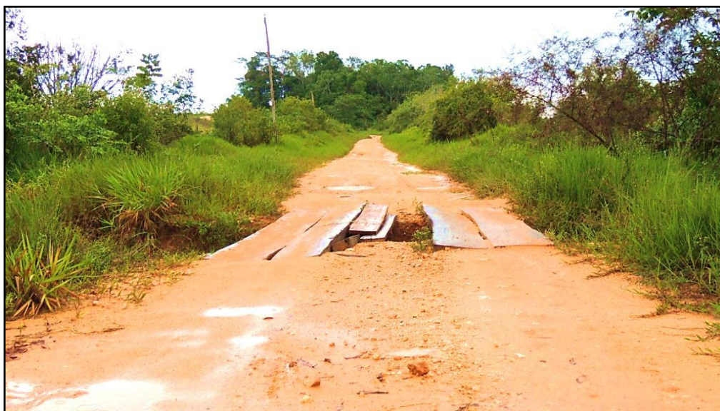
Figura 15: Ponte em mal estado de conservação na Vicinal 06
