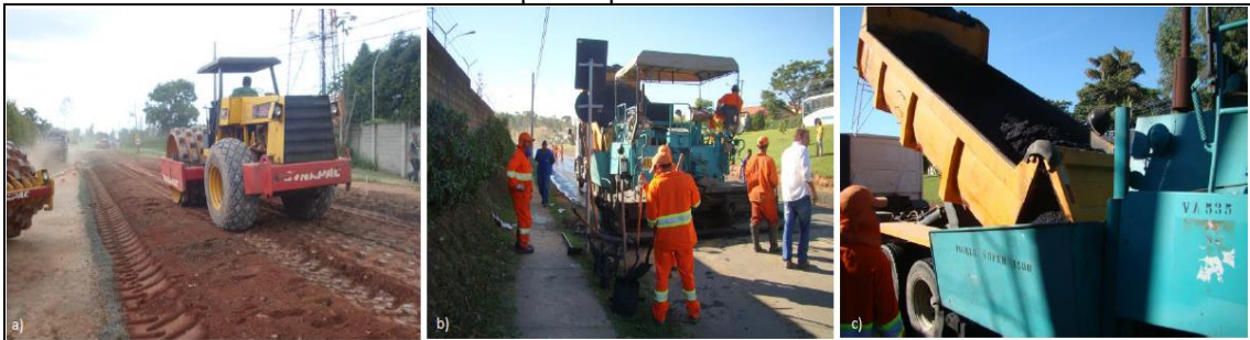
Figura 24 a) Compactação da camada com rolo pé de carneiro; b) e c) Vibroacabadora em operação na pista experimental.
