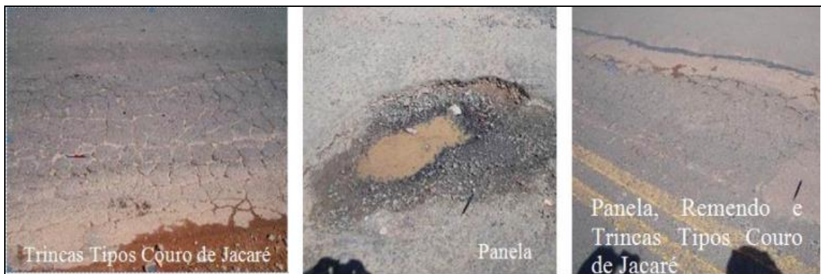
Figura 10 – Patologias encontradas no pavimento da pista experimental SP 332.
