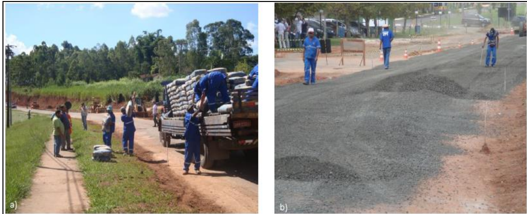
Figura 22 – a) Recebimento dos sacos de cimento (CP II E 32); b) Espalhamento manual do cimento Portland sobre a pista experimental.
