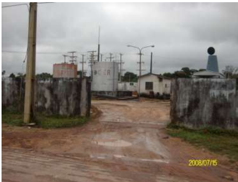
Figura 13 - Subestação da CER na sede do município de Rorainópolis Fonte: Imagem do acervo de Ana Maria Alves (2008)
