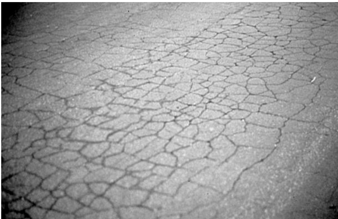
Figura 2.3 – Trincamento por fadiga em estágio avançado (FHWA, 2000).
