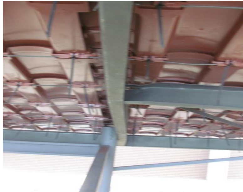
Figura 83 - Deformação excessiva na viga transversina interna V 8 - Estado Limite de Utilização.
