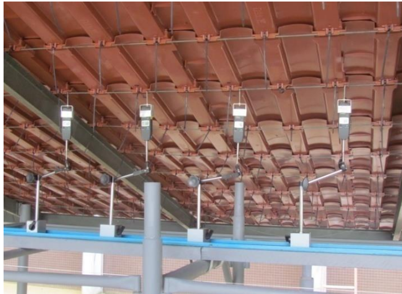
Figura 74 - Montagem do sistema de medição de deslocamento vertical da cobertura.
