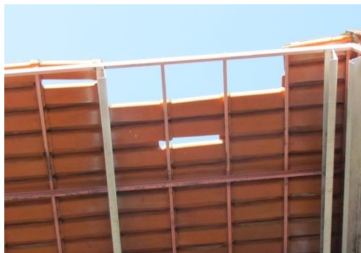
Figura 33 – Parte da cobertura com telhas cerâmicas retiradas devido à força do vento.
