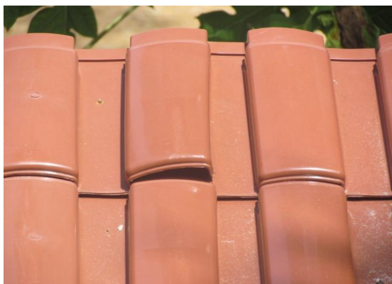
Figura 82 - Deslocamentos de telhas após a aplicação de postensão nas barras.
