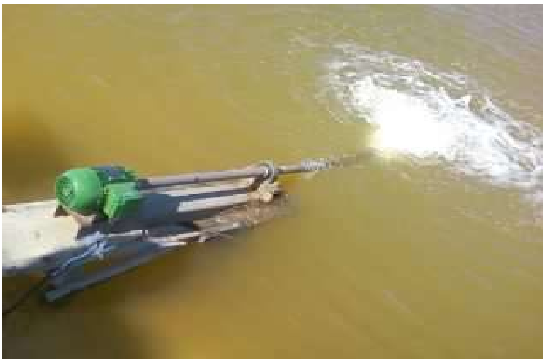
Figura 9 Aerador propulsor de hélice.
