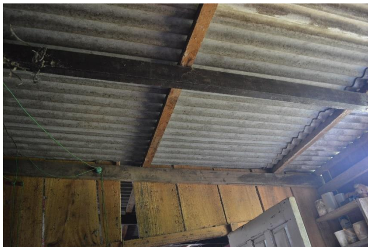
Figura 55 - Detalhe do telhado da casa da família beneficiada sem forro.
