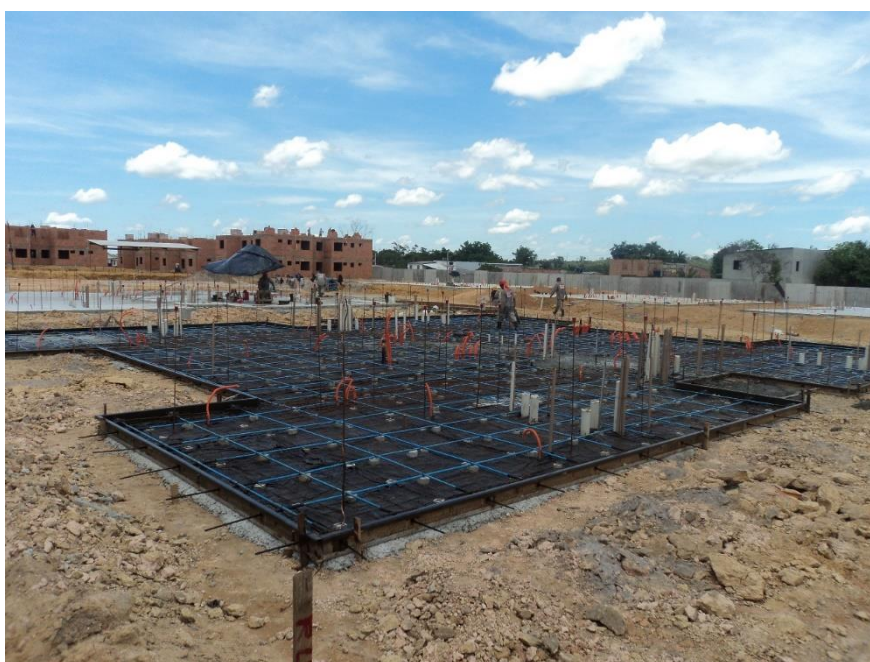
Figura 22 - Fundação tipo radier para o sistema empregando paredes monolíticas de concreto. Fonte: Vasconcelos e Santiago (2011).
