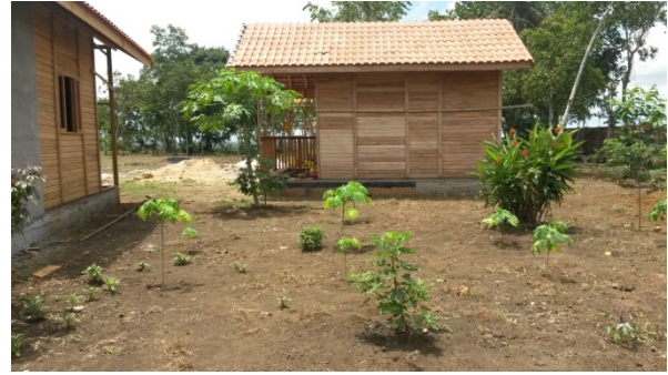
Figura 14: Pousada em construção pertencente a um casal que migrou para a Comunidade. Crédito: Margaret Cerqueira.
