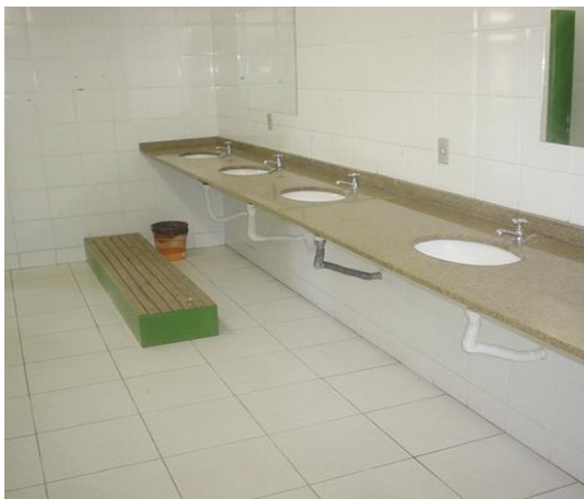
Imagem 28: Lavatórios em Altura Inadequada. Fonte: Dischinger, 2009.
