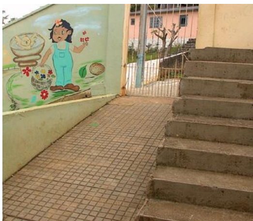
Imagem 14: Escadas muito Estreitas. Fonte: Dischinger, 2009.
