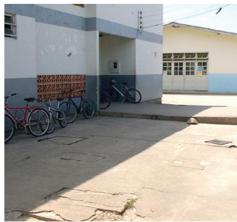
Imagem 37: Piso Inadequado e com Desnível. Fonte: Dischinger, 2009.
