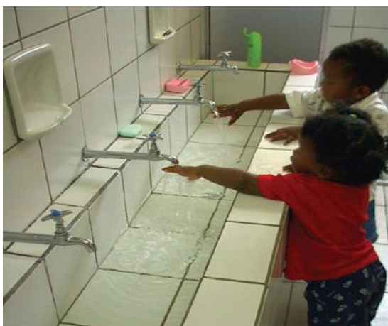
Imagem 22: Mobiliário Inadequado às Dimensões. Fonte: Dischinger, 2009.
