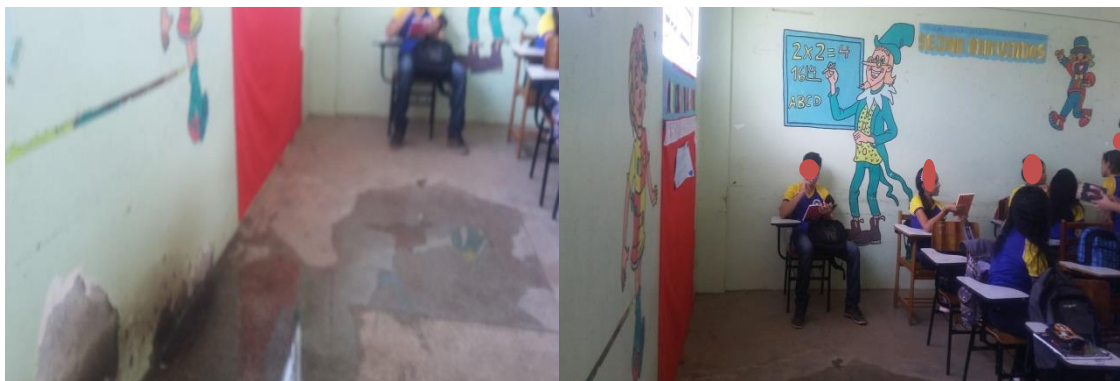
Figura 5 – Chão da sala alagado
