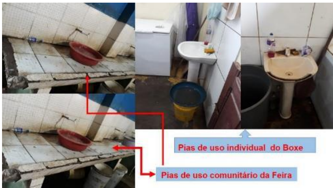
Figura 8 - Espaço geral da pia de uso comum para os trabalhadores da feira e torneiras nos boxes
