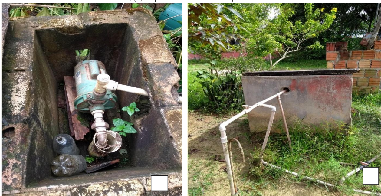
Figura 20: Sistemas de captação de água no bairro Santa Rosa, Tabatinga, Amazonas. (a) Poços tubular sem cobertura; (b) Poço tubular sem manutenção no entorno.
