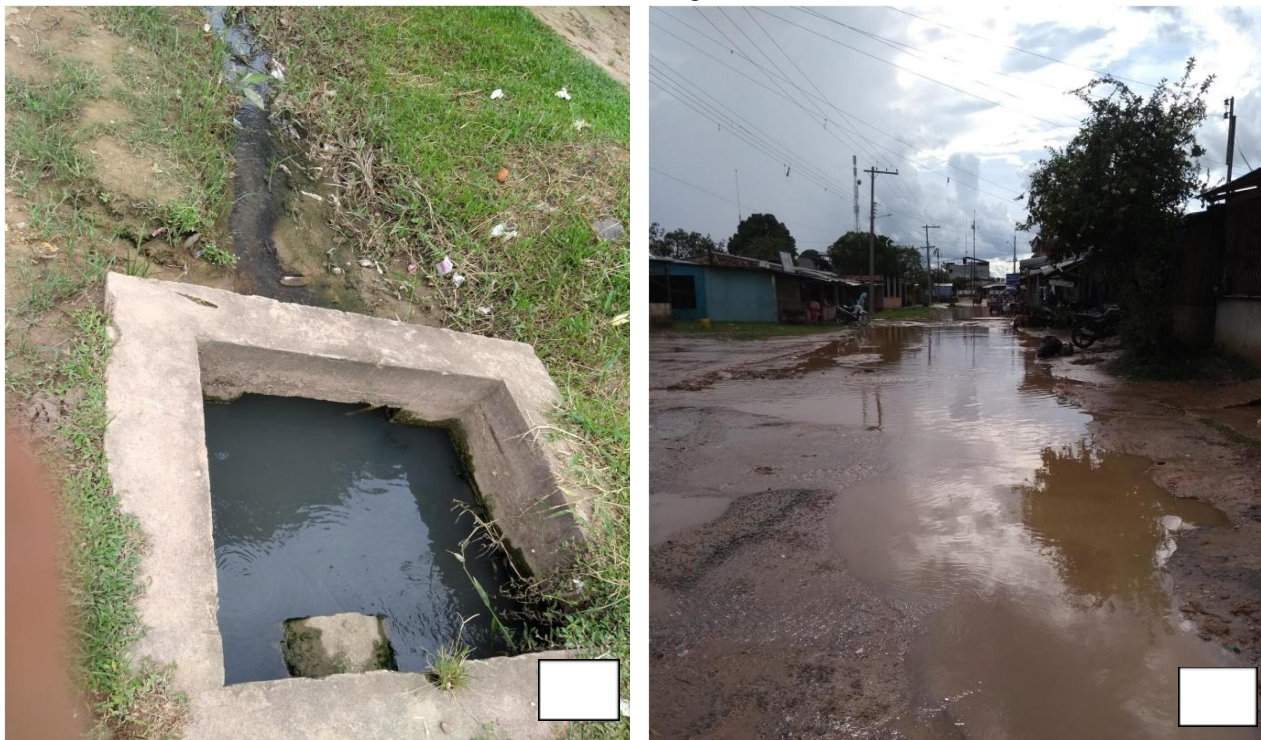
Figura 22: Ausência de Saneamento Básico. (A) Bueiro com água contaminada proveniente de efluentes doméstico, localizado na rua Geodésica 1, forte odor e presenças de resíduos sólidos. (B) Fotografia da rua Isaias Costa, após precipitação as águas se misturam com o esgoto das valas, formando lagos de águas turvas e odor desagradável no bairro Santa Rosa, Tabatinga, Amazonas.
