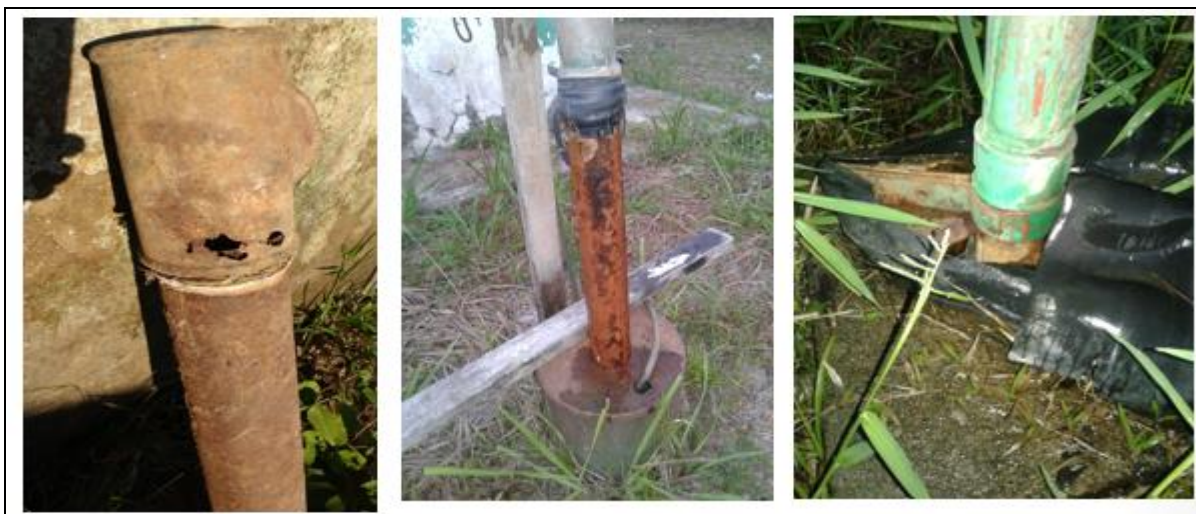
Figura 24. Prejuízos causados pelo uso prolongado das tubulações
