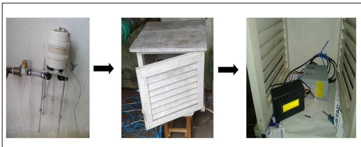
Figura 14. Sistema de aquisição de dados instalada no poço PT17.
