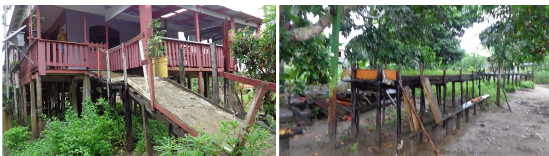
Figura 31. Registro de estruturas suspensas, devido as cheias (moradia e jiraus suspensos) na comunidade Nossa Senhora de Nazaré no Distrito da Terra Nova.
