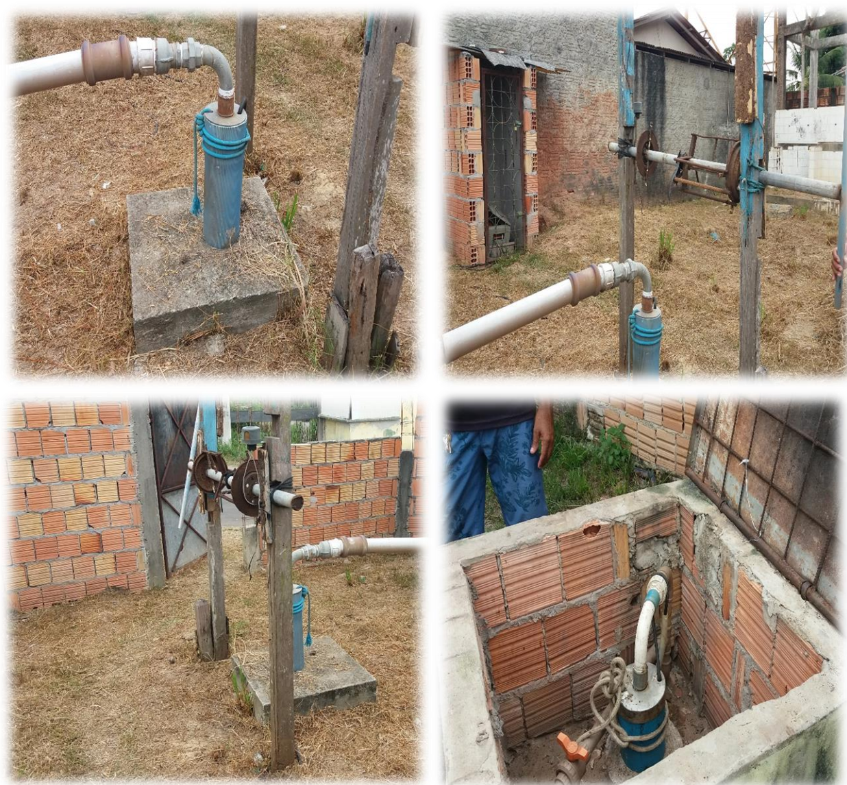
Figura 8 – Partes dos sistemas de abastecimento de água na vila do Puraquequara
