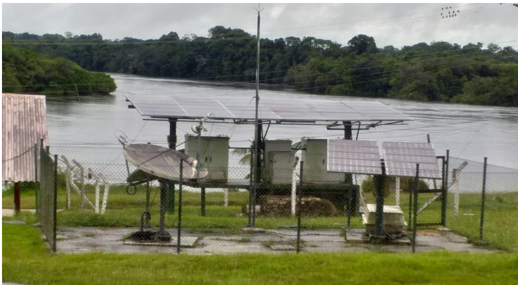
Figura 24: Estrutura com placas solares e equipamentos do GESAC para o fornecimento de internet no distrito de Querari, fronteira com a Colômbia, em SGC. Foto enviada por Joel Antônio Carvalho Ferreira, indígena da etnia Tukano.
