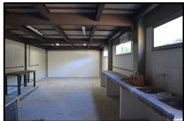
Figura 58: Parte interna do prédio cedido pelo DEMAT Crédito: Acervo fotográfico do Laboratório, 2013
