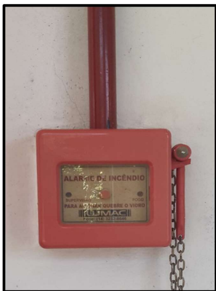
Figura 80. Imagem do alarme contra incêndio Crédito: Karem Teles, 2021
