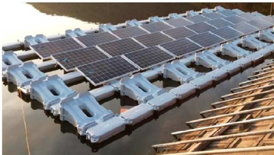
Figura 2 - Aspecto de um sistema fotovoltaico flutuante
