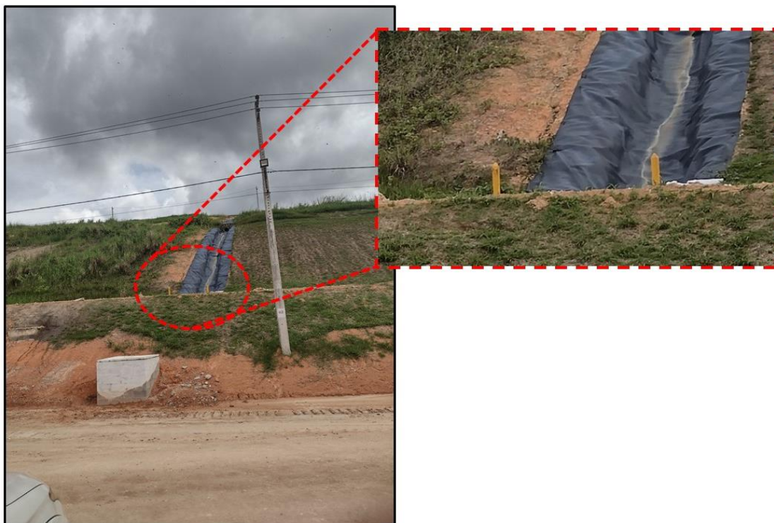
Figura 32: Piezômetro para o monitoramento do chorume nas células de implantação
