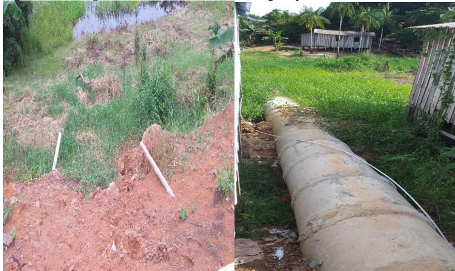
Figura 09 e 10 Águas servidas das residências e Águas pluviais
