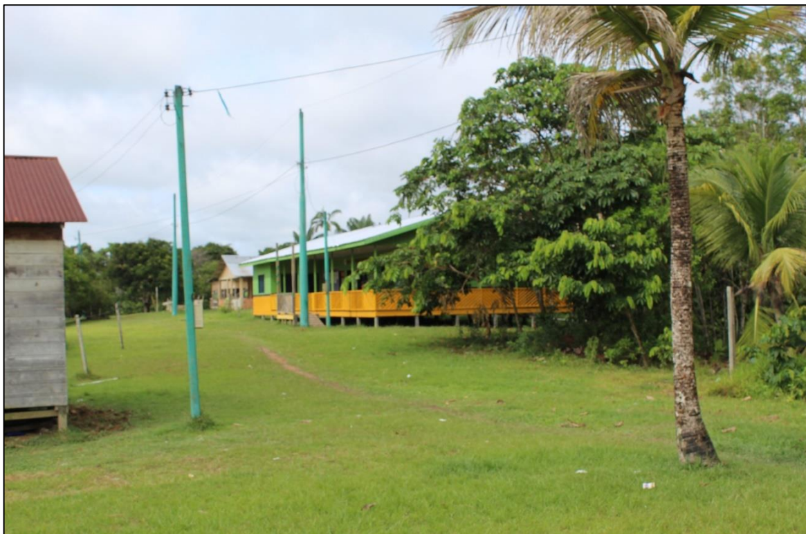
FIGURA 20 – Poste de Alta tensões “Projeto Luz para todos” Comunidade São Pedro do Norte - AM
