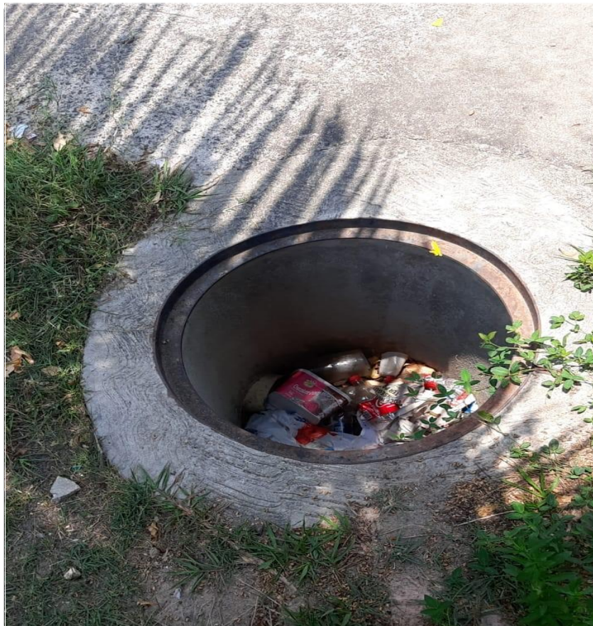
Figura 28 - Resíduos na rede de esgoto
