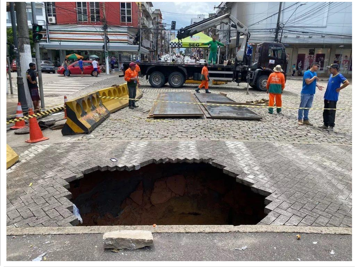
Figura 27 - Antiga galeria dos ingleses rompeu e causou o afundamento
