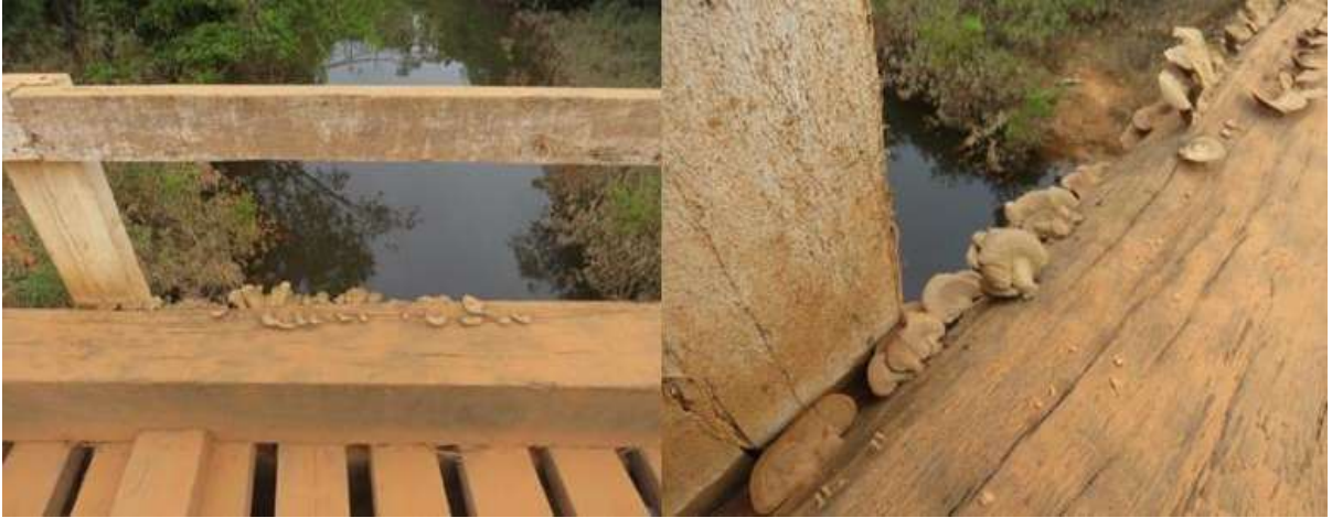
Figura 24 – Estrutura Guarda-rodas da ponte Igarapé Bandeirão atacada por Trametes sp.
