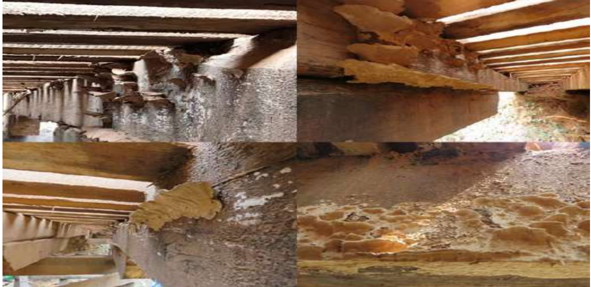
Figura 18 – Situação da Longarina da Ponte Igarapé Beleza atacada por Earliellacorrugata
