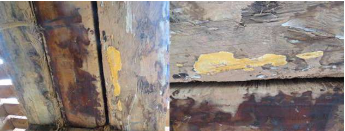
Figura 23 – Balancim da ponte Bandeirão degradada por fungos corticoides linocelulolíticos
