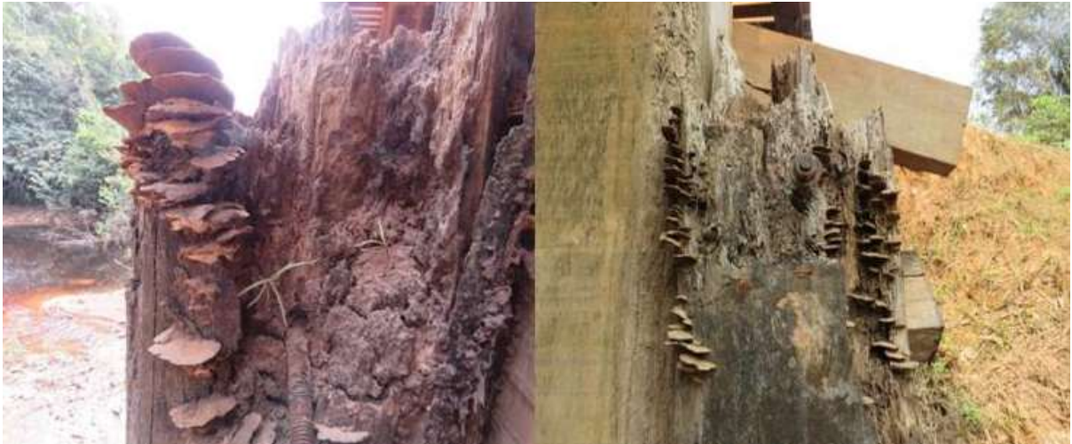
Figura 19 – Pilar substituído da Ponte Igarapé Beleza atacada por Phellinus sp.
