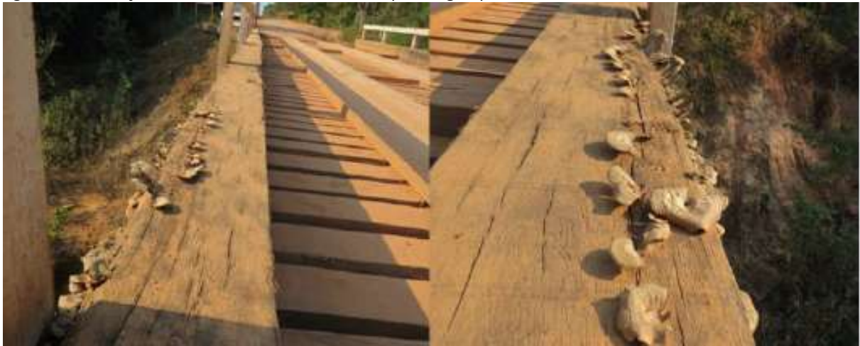
Figura 16 – Situação da estrutura Guarda-rodas da ponte Igarapé Beleza
