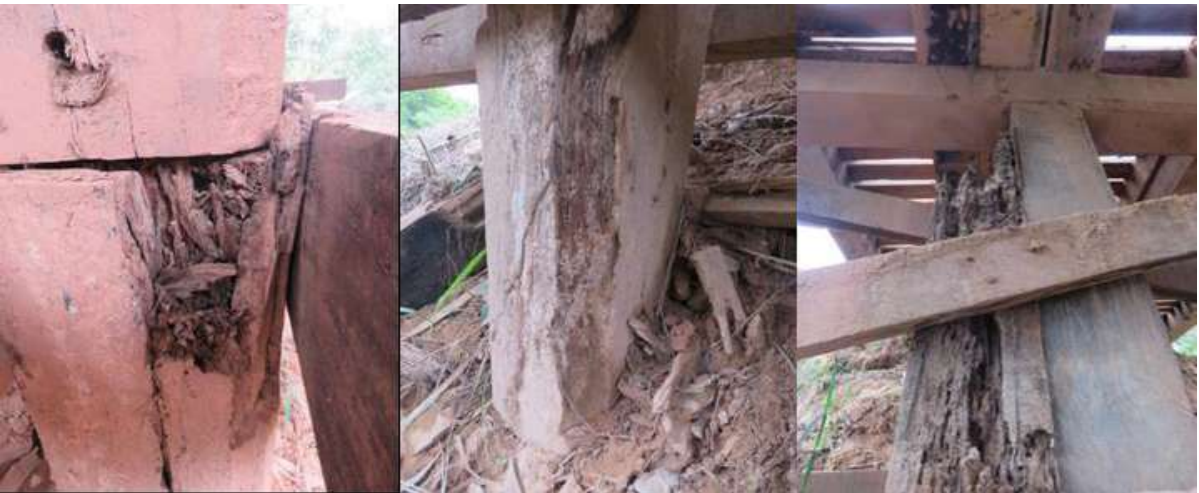
Figura 25 – Pilares da ponte Ig. Bandeirão com degradação severa causada por fungos e cupins
