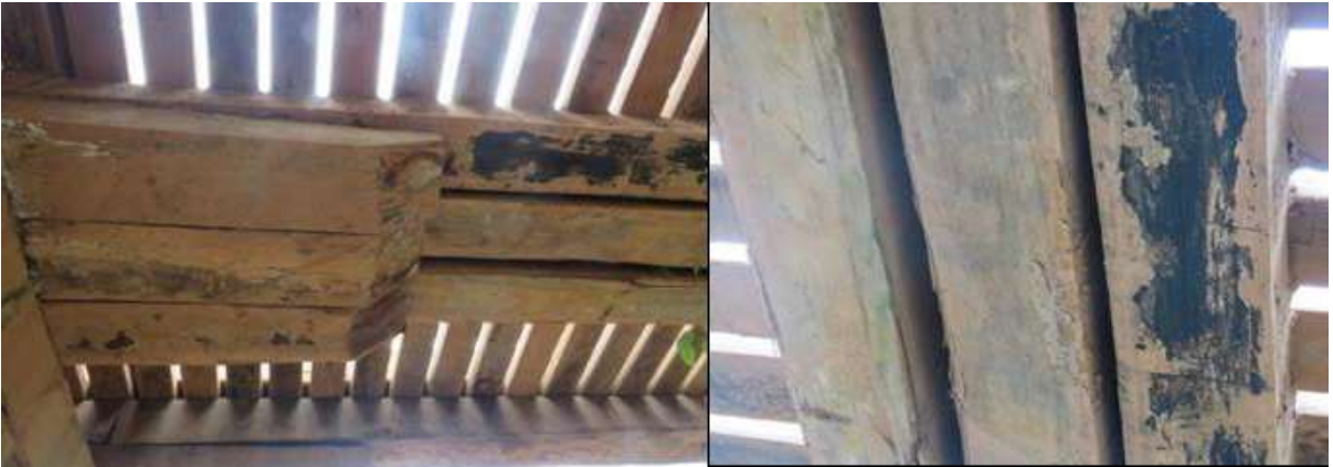
Figura 22 – Aspecto da longarina e balancim da ponte Igarapé Bandeirão atacada por fungos
