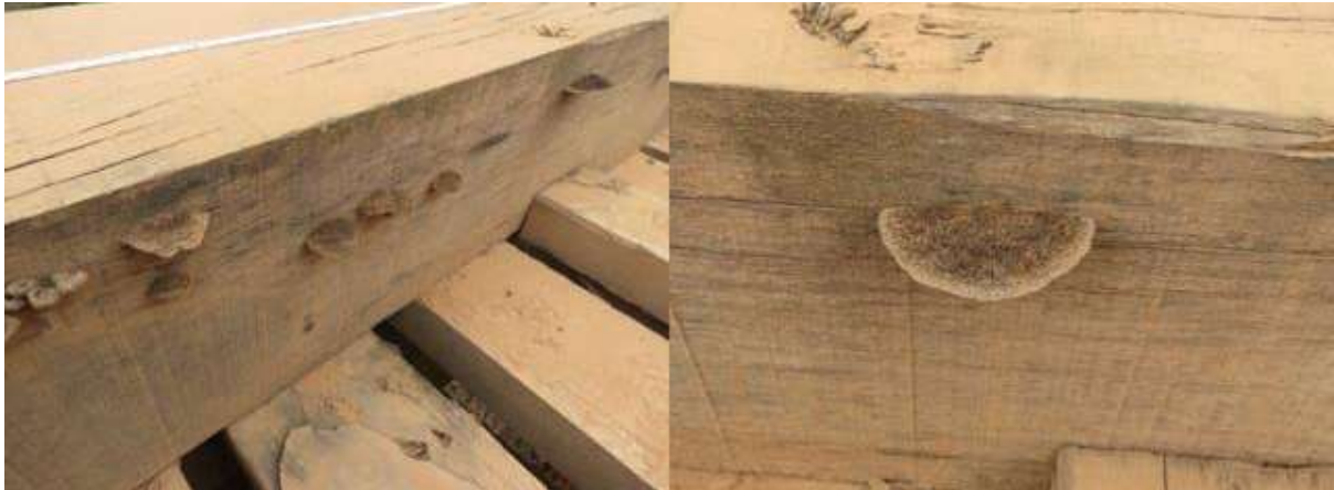
Figura 20 – Guarda-rodas da ponte Igarapé Bandeirão atacada por Hexagonahydroides
