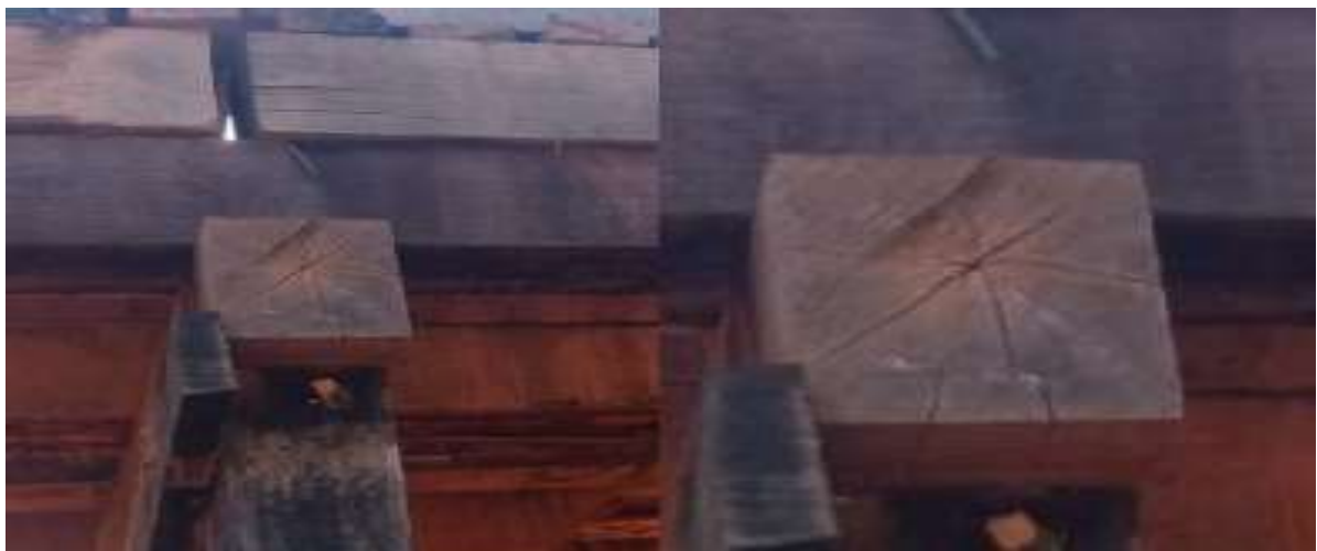
Figura 26 – Exemplos de rachaduras de topo
