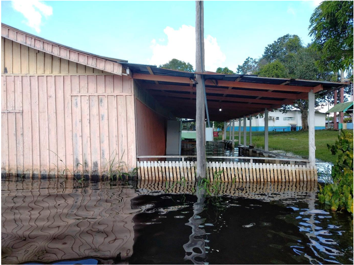
Figura 6. Casa inundada pela cheia de 2022. Ao fundo, a UBS da localidade (Foto da autora).
